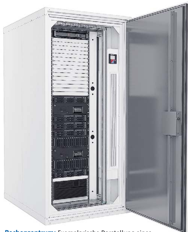
Rechenzentrum: Exemplarische Darstellung eines Edge-Serverschranks. Foto: Vertiv
